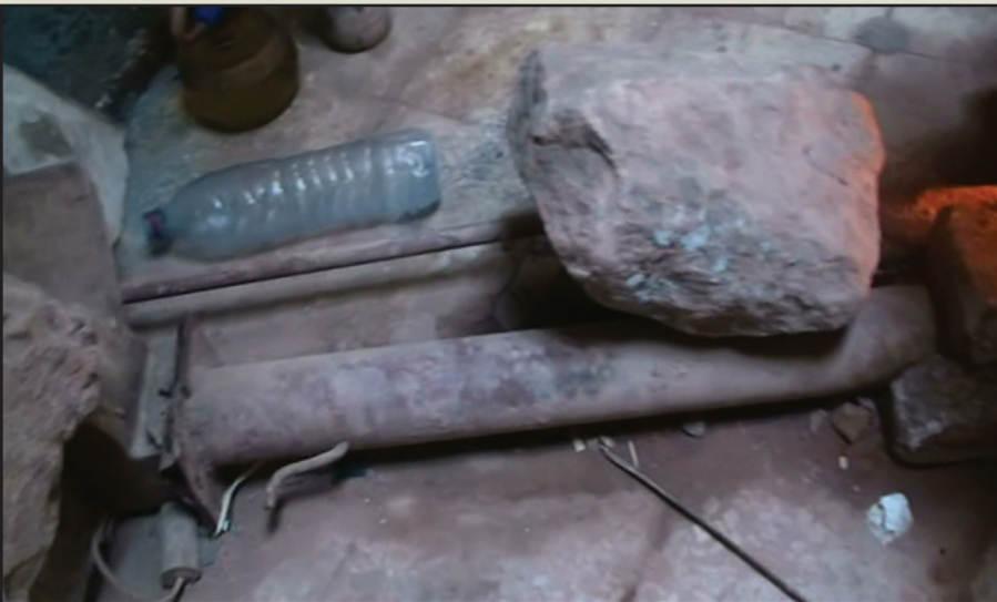
شكل (٥) مواسير الغاز والهواء وهى تتجه داخل بيت النار
